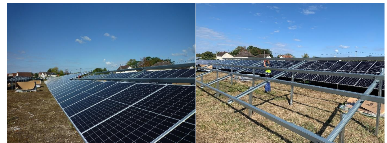
Illustration 35 : Montage des structures porteuses et des modules sur la centrale photovoltaïque de Salbris (41) (Source : EREA Ingénierie)
