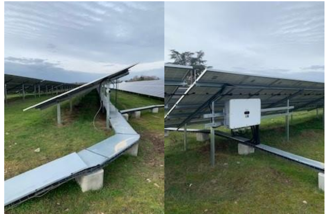
Illustration 29 : Exemple de câblage aérien réalisé sur la centrale de Salbris (41) (Source : EREA Ingénierie)
