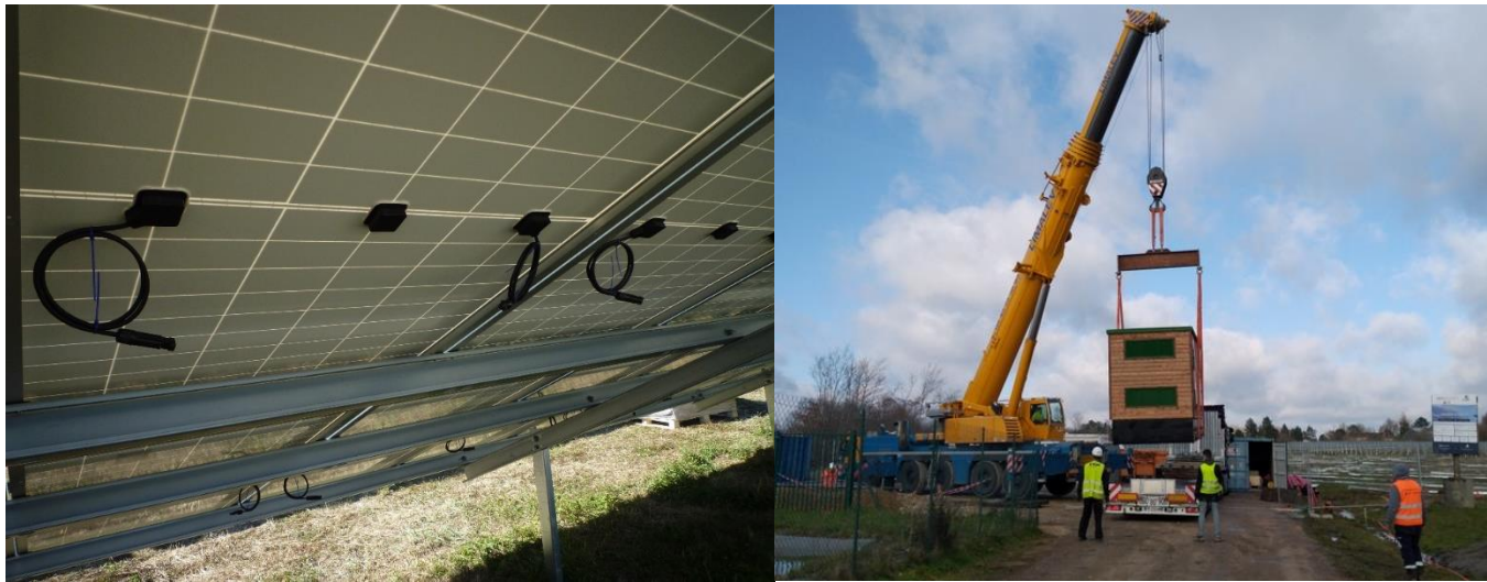
Illustration 36 : Raccordement des modules – centrales photovoltaïques de Salbris (41) et Saint-Jory de Chalais (24) (Source : EREA Ingénierie)
