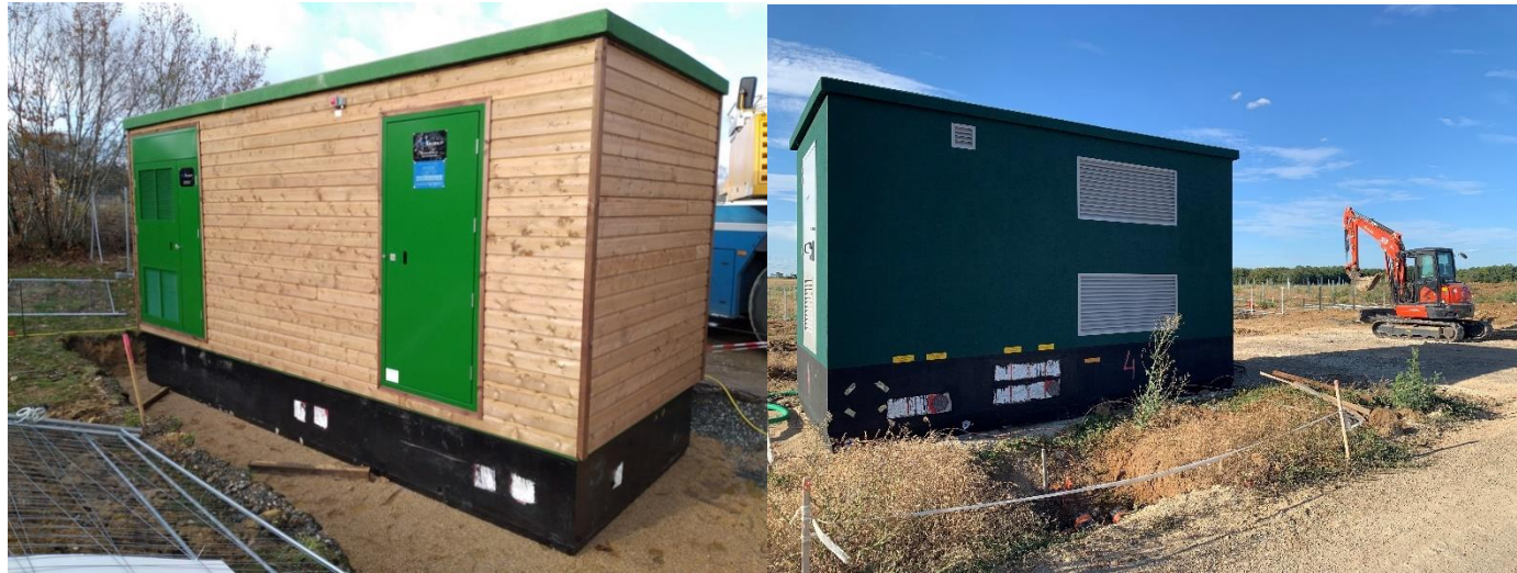
Illustration 28 : Exemple de postes de livraison respectivement sur les centrales de Saint-Jory de Chalais (24) et Mer (41)
